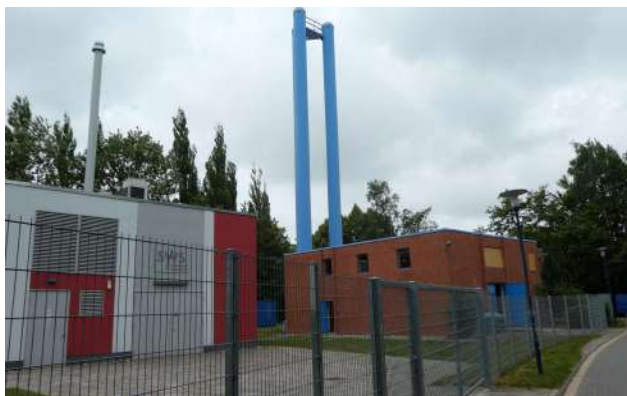
Abb. 13: neues Block-Heizkraftwerk Quelle: Fotos Antje Wunderlich, 12.07.2018
